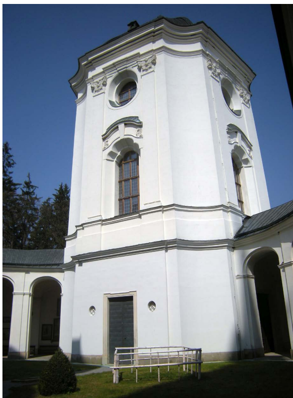
Foto 6 Oplocenka před kaplí svaté Anny upozorňuje na totální propad po zřícení klenby na podzemní chodbě pod j. ambitem (foto Marek Gyaneshwarpuri, 2009).
