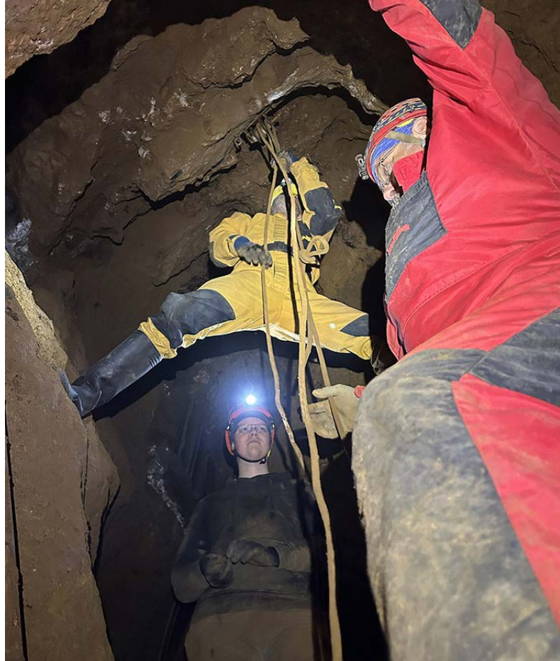
Foto 1 Instalace těžního zařízení nad šachtou Slepá vášeň v Tetínské propáستce (foto M. Hejna)
