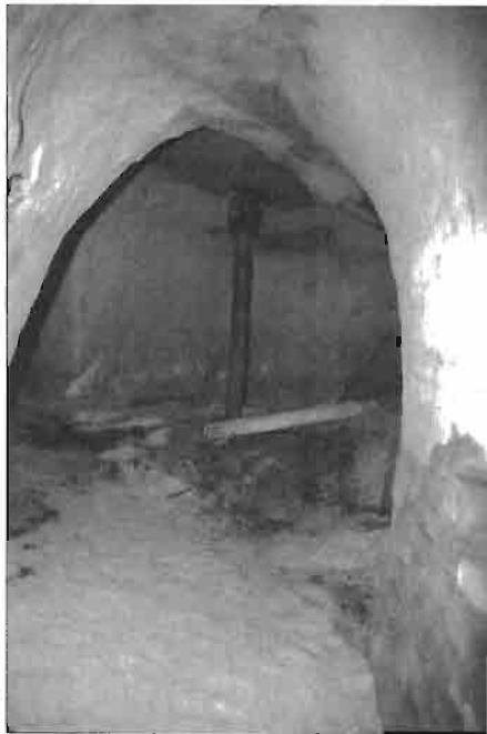
Obr. 4. Podzemí v Hostěradicích – nestabilní strop (foto J. Prokop).
