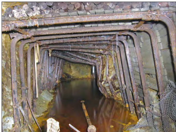
Porucha ve spojovací chodbě -1106- na štole Mír se od r.1986 do r.2005 také příliš nezměnila
