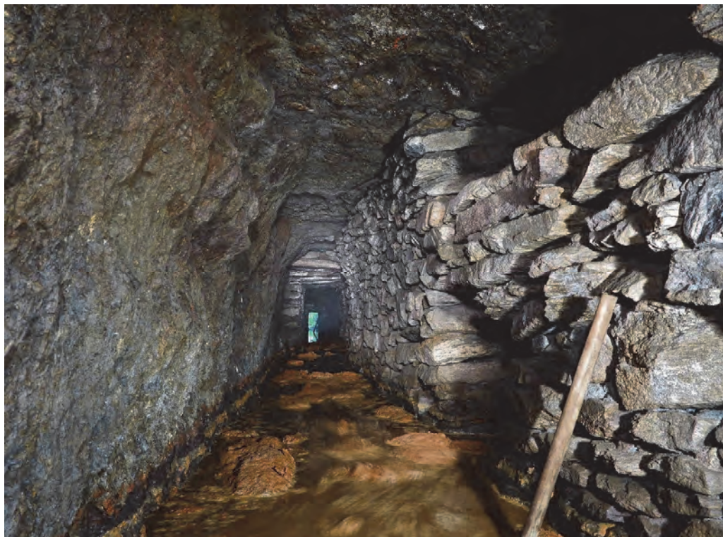
4. Průhled profilem štoly ze staničení cca 40 m směrem ke vchodu, vpravo se nachází v zakládce průchod do levé odbočky končící ve stařinách, foto Tomáš Janata, 2013.
