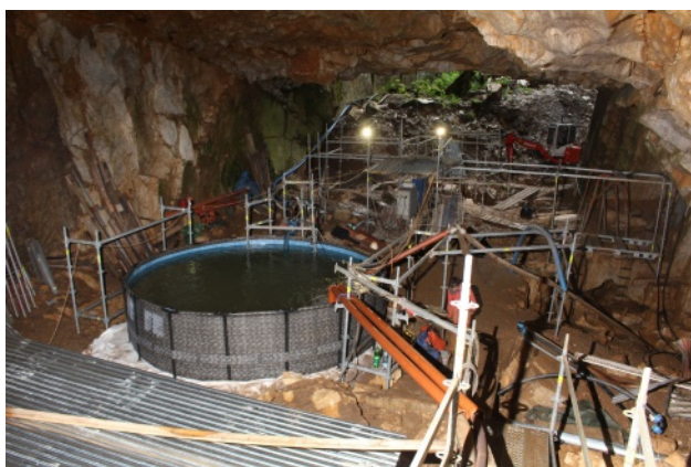
Přečerpávací nádrž a velín v Komoře.
