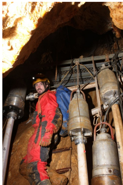
Soustava kalových čerpadel ve Velké mramorové propasti byla spouštěna s klesající hladinou
