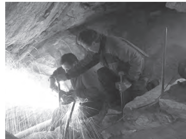
Instalace kovových stojen zábradlí na lávkách ve Schwarzenberské chodbě. Foto: Archiv Správy Chýnovské jeskyně.
