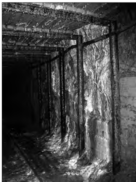
Obr. 16 Tramvajová štola, sintrové náteky a koroze výztuže
