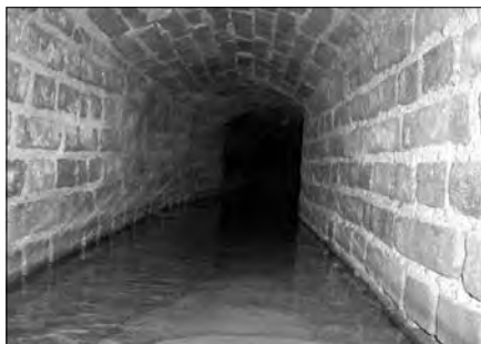
Foto 1 Stará lázeňská štola je částečně vyzděna tam, kde podsedá pilíře železničního mostu. Stavební společnost měla při stavbě železniční trati z Mostu do Hrobu za úkol zachovat důlní prostory a tudíž došlo v roce 1879 k vyzdění kleneb v již vyražené štole ze 17. století. (Foto P. Chaloupka)
