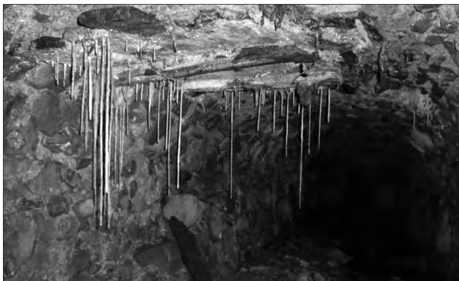
Foto 3 Původní vstupní část štoly, vyzděné v délce asi 50 m kamennou vyzdívkou (Foto P. Chaloupka)
