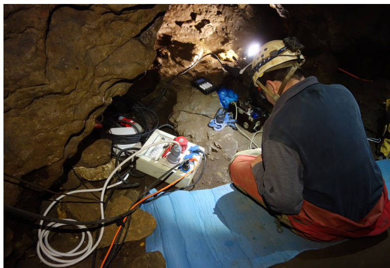
Foto 2 Obsluha rozvaděče (foto V. Bláha)
